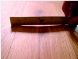
Hier wird das Holz von unten durch Feuchtigkeit beeinflusst. Bild: Lysser
